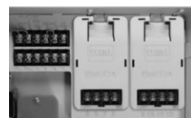
Configuration 12 voies avec 2 modules de 4 voies
